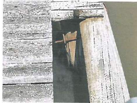
Outra estaca que apresentava problemas de incolumidade.
