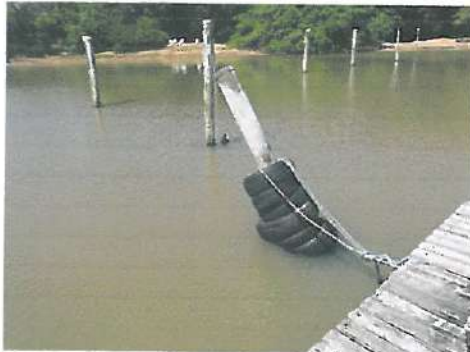
Estacas danificadas, como a ilustrada na foto, foram substituídas.
